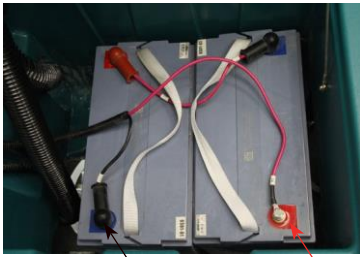
Отрицательный провод аккумулятора (черный)
